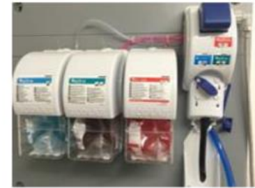
Centrale de dosage
